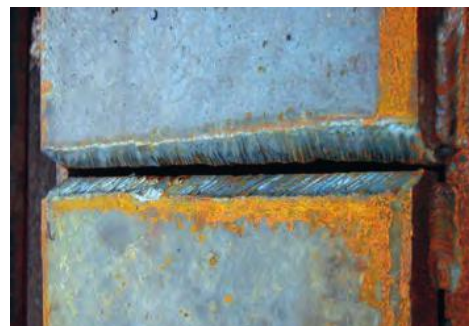
آماده‌سازی نامناسب درز جوش شیاری
