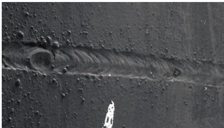
شکل ۱۲-۱۶- عدم پرشدگی شیار
